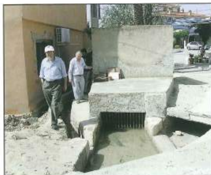
Figura 17.- Entrada del caudal de agua en El Partidor.
