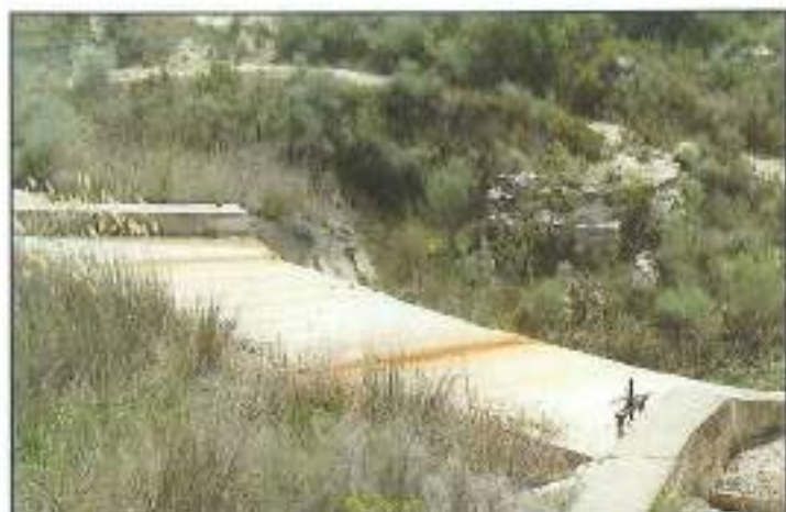
Figura 11.- En la foto se ve en primer término un detalle del azud actual del Partidor y, al fondo y destruido por el torrente, el antiguo azud del siglo XVI donde con anterioridad comenzaba la red de regadío andalusí-mudéjar. A continuación reportaje fotográfico del sistema hidráulico y la huerta de Abanilla.
