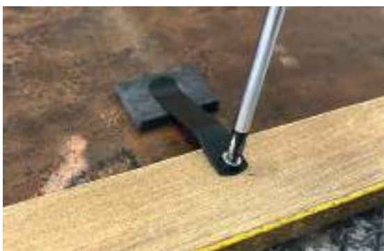
33. Detalle del nuevo sistema de montaje al marco.
